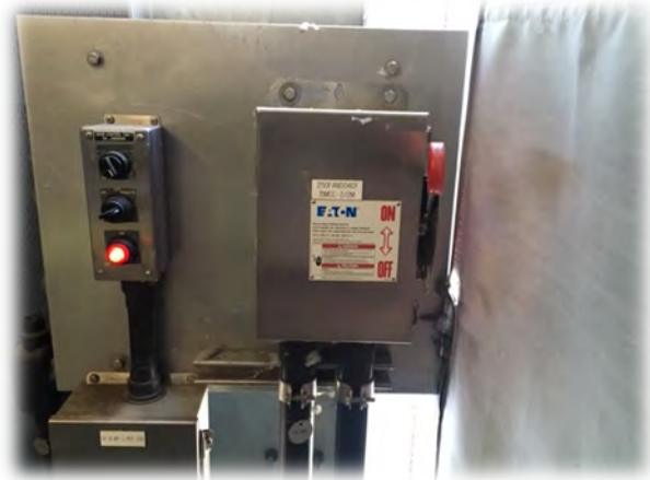
4) Air Flow Fan Shut Off
