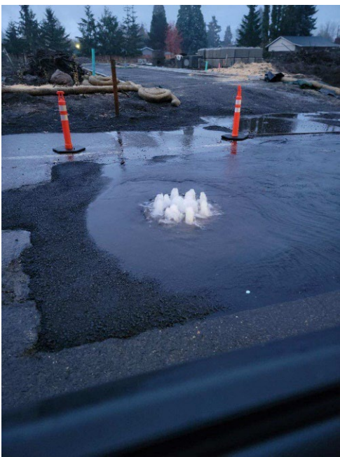
Storm Surge (2316 SE Courtney)
